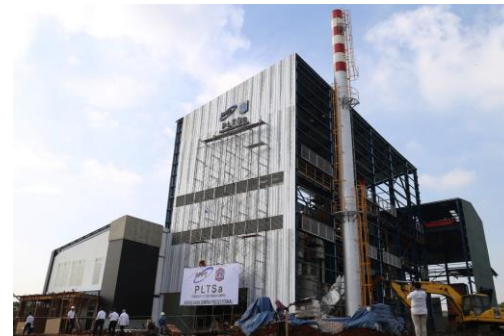
Pembangkit Listrik Tenaga Sampah Bantar Gebang (sumber: dokumentasi pribadi)
